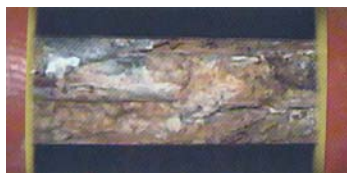
skorodované kovové potrubie
